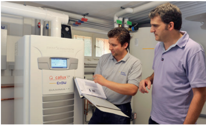
Das Interesse der EnBW-Kunden an Callux ist groß. Seit Juli ist auch ein Privathaushalt in Tamm bei Stuttgart Standort einer Brennstoffzellenheizung. Bild: EnBW
